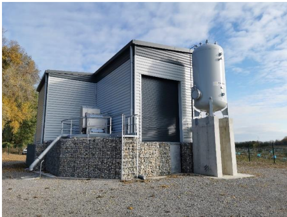
Station de pompage de la Poulatte
